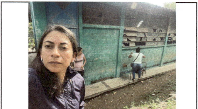
Foto 6: Módulo A, evaluadora frente a ventanas con vidrios quebrados
