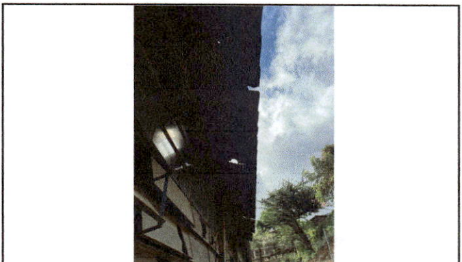
Foto 4: Módulo A, techo en mal estado
